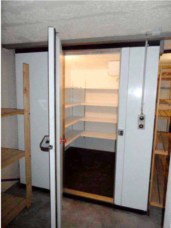
Die zwei Kühlräume
