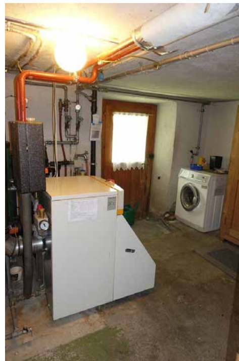
Die Heizung und Waschküche
