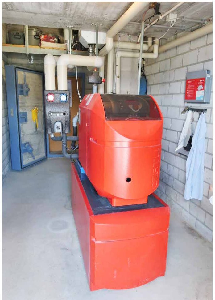
Die Ölheizung für die zwei Haushälften
